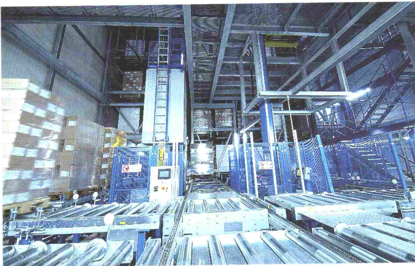
Bild 2 Fördertechnik in der Vorzone des TK04.
